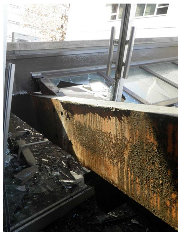
1C棟 出入口(建具の破損状況)
