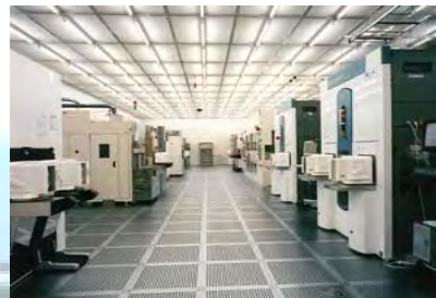
△スーパークリーンルーム
