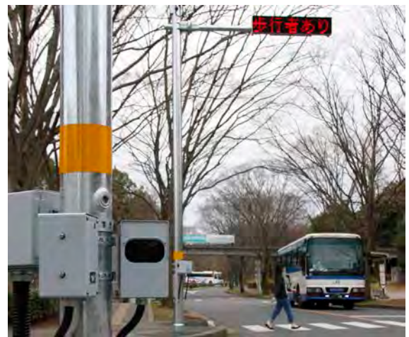
本部棟前に設置されたセンサー
