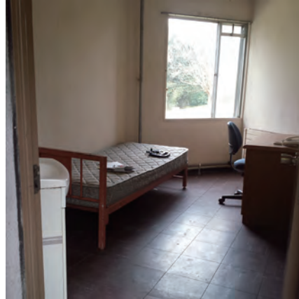
最も老朽化が進む平砂未改修棟の部屋 (4月3日撮影)
