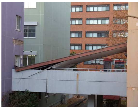
事故当時の崩落現場(昨年12月10日、第一エリアで) = 木村誠撮影
