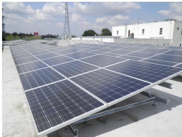
中央機械室屋上太陽光パネル
