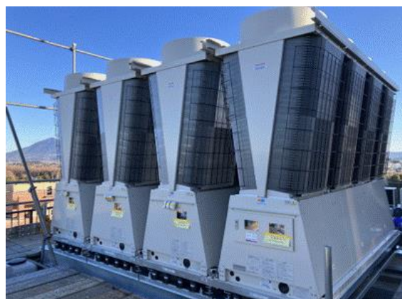
（空調用空冷ヒートポンプチャラーユニット）
