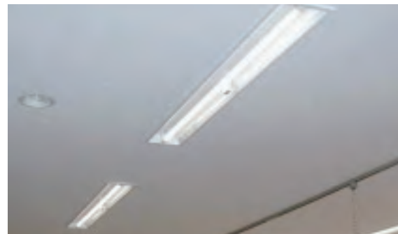
4B 棟学生ラウンジ LED 照明器具
