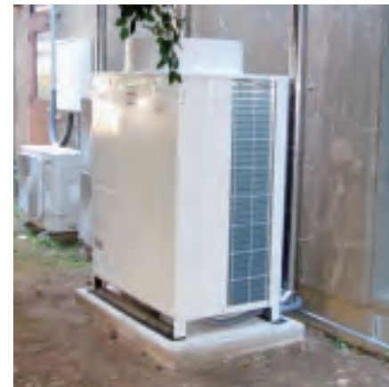
医科学棟の空調用室外機
