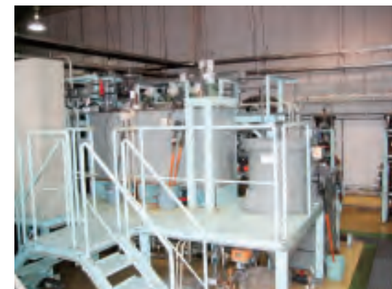
鉄粉法無機系廃液処理施設
