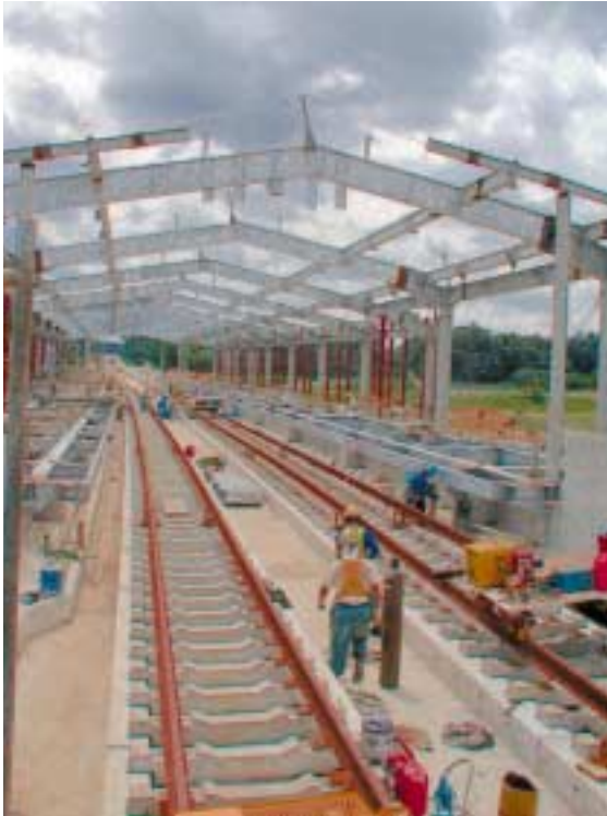
茨城県と東京都の境界を走るつくばエクスプレスの建設現場。線路と駅舎の骨格が立ち上がり、周囲は建設工事の賑わいで溢れている。
