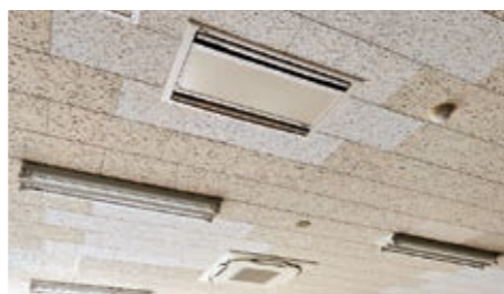
春日地区講義室換気設備
